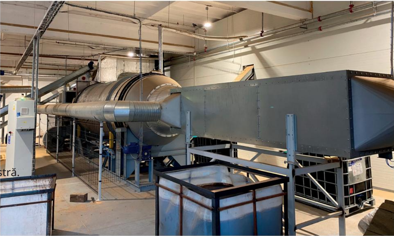
/ 2. Recuperator care recuperează 200 kW de căldură la o temperatură de 170°C
