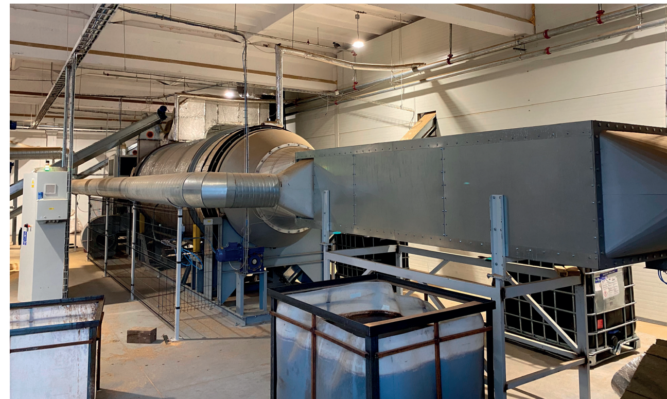
/ 2. Rekuperator, który odzyskuje 200 kW ciepła/t o temperaturze 170°C
