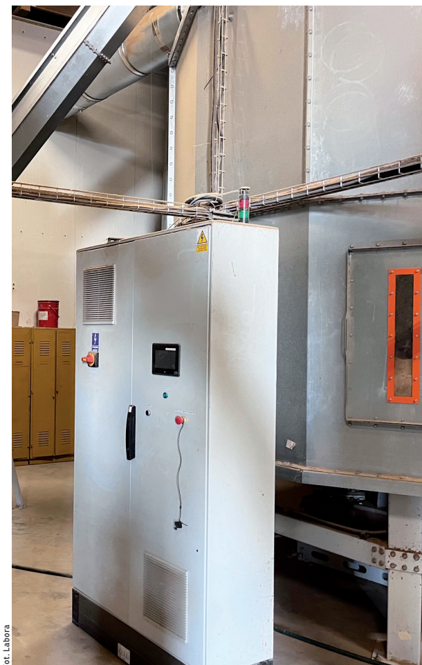
Na pierwszym planie szafa sterująca suszarnią, a w tle suszarnia pionowa Eco Air Dryer 1000.
